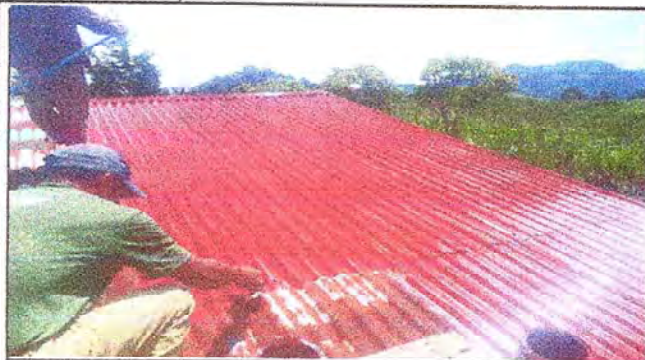
PINTADO DE LAMINA POR DETERIORO
