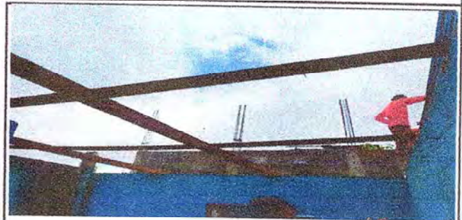
No. 8 sustitución de techo de cocina por deterioro
