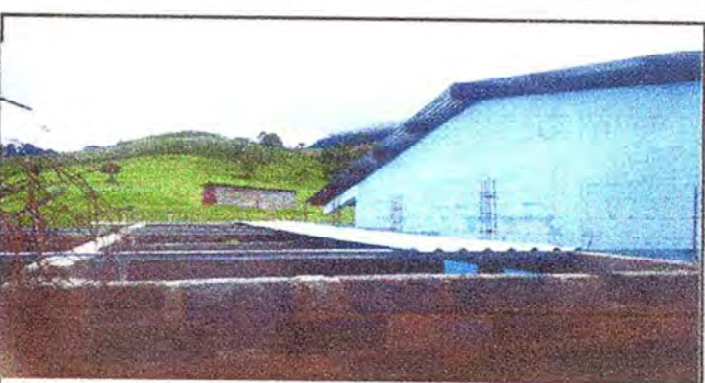
SUSTITUCION DE TECHO DEL BAÑO POR DETERIORO
